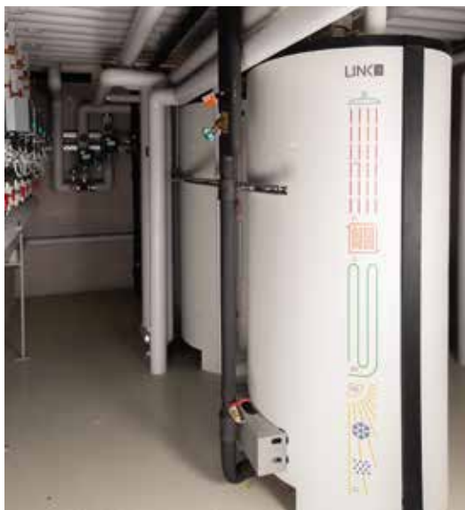
Beispielinstallation mit zwei Schichtenspeichern im Explorer Hotel.
