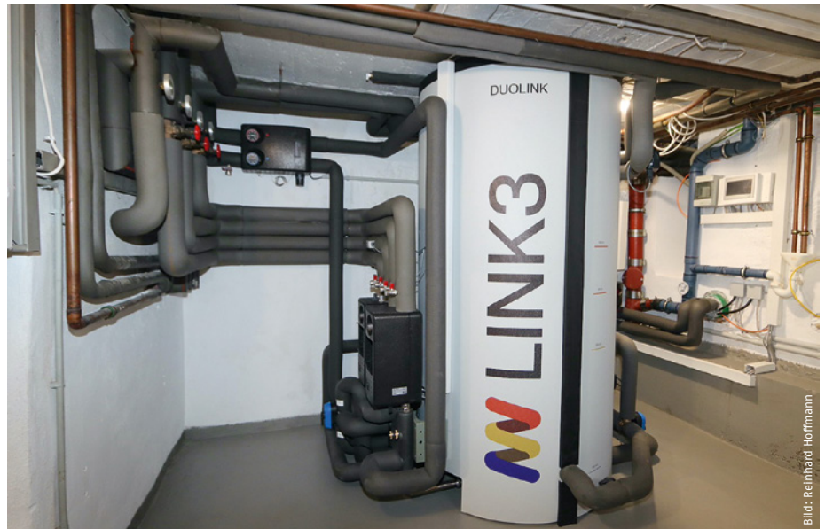
Bild 2: Der Schichtenspeicher DUOLINK-Cool bildet einen wichtigen Teil des Gesamtkonzepts.
