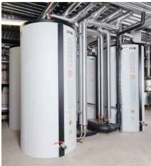
Beispiel 2 – Vier Powerlink-Speicher stellen jetzt die hygienegerechte Versorgung der großen Anlage sicher.
