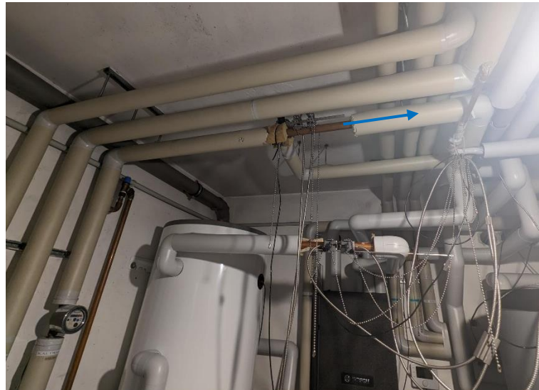
Messstelle Frischwasser (Vorher- (& Nachher-) Messung)
