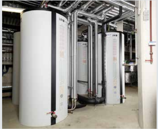
Nach dem Umbau der Anlage stellen vier Powerlink-Speicher die hygienegerechte Versorgung der großen Anlage sicher.
